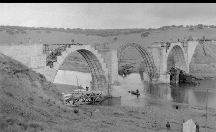
Hormigonado de los extremos del puente Mariago sobre el río Águeda, en el pk 98,275 de la línea de Salamanca a Fuentes de Oñoro, entre los municipios salmantinos de Saelices el Chico y Carpio de Azaba. 1943.
