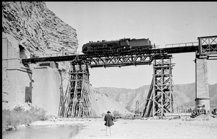
Prueba de carga de los castilletes de traviesas y tramo de vía provisional en el viaducto sobre el río Matarraña. 1931.
